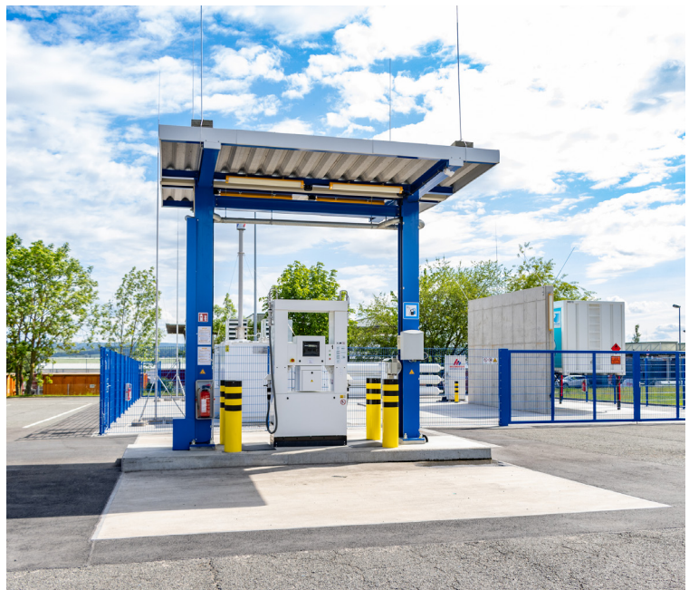
30 _ Wasserstofftankstelle in Weimar
